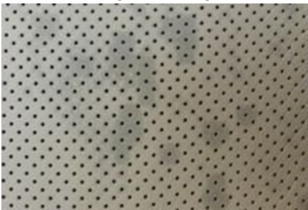
Flecken durch eingezogene Feuchtigkeit.
